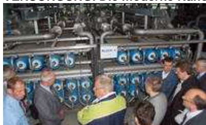
Auch für Experten aus anderen Ländern interessant: die Nanofiltration im Wasserwerk Löhnen. (Archivfoto: Lars Fröhlich)
