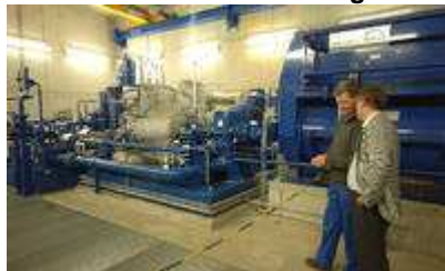
Im Inneren des Frischholz-Kraftwerkes Gerhard-Malina-Straße. (Archivfoto: Kunkel)
