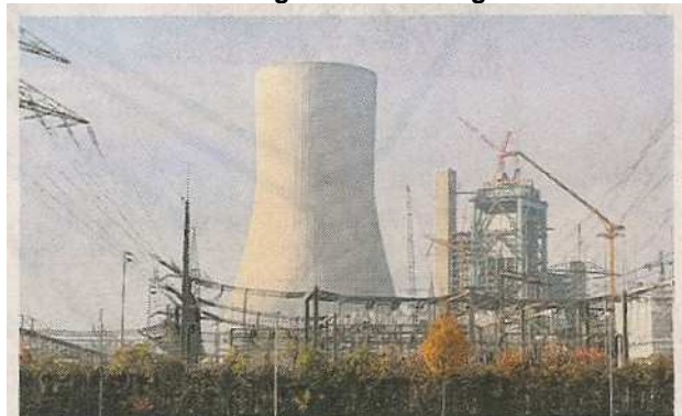
„Die Steinkohle ist aus dem Energiemix nicht wegzudenken“: Kraftwerks-Neubau in Walsum. (Foto: Geinowski)
